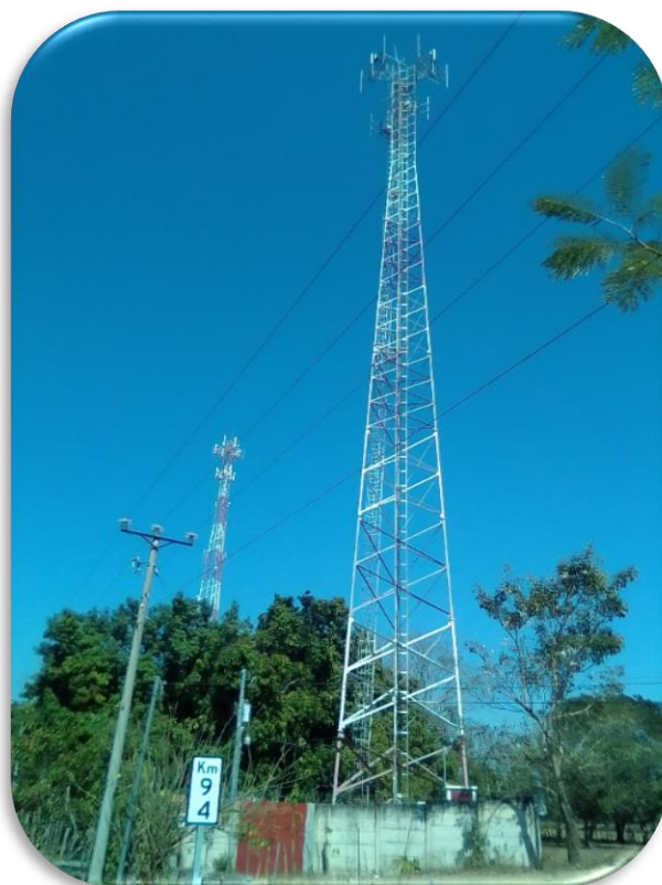
Fotografía 29. Antenas de transmisión ubicadas a las cercanías del instituto El Pacún
