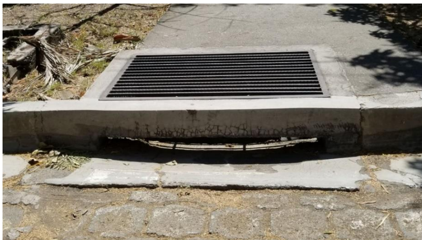
Tragante de aguas lluvias
