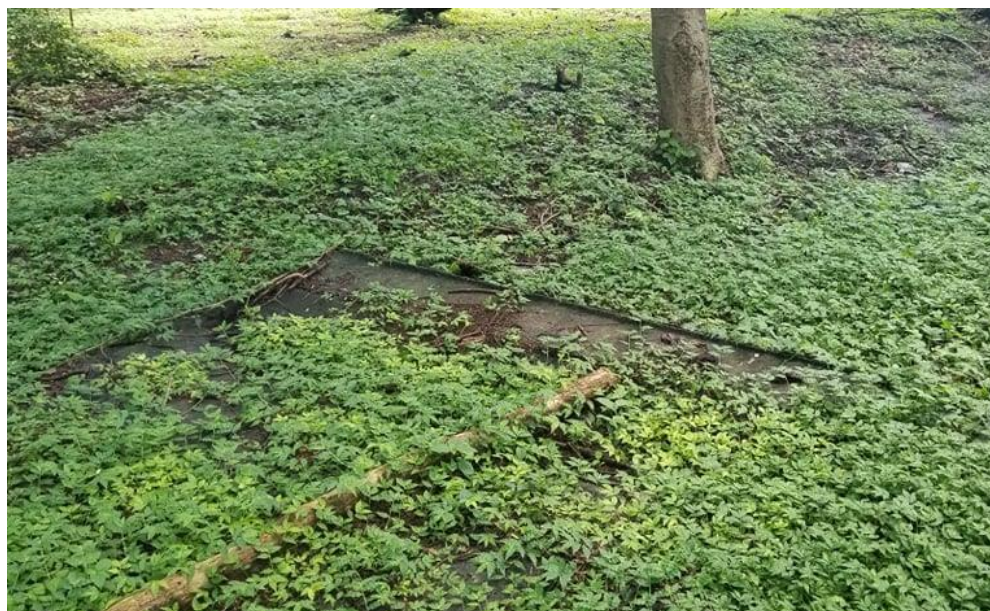
Fosa séptica del edificio de la Biblioteca
