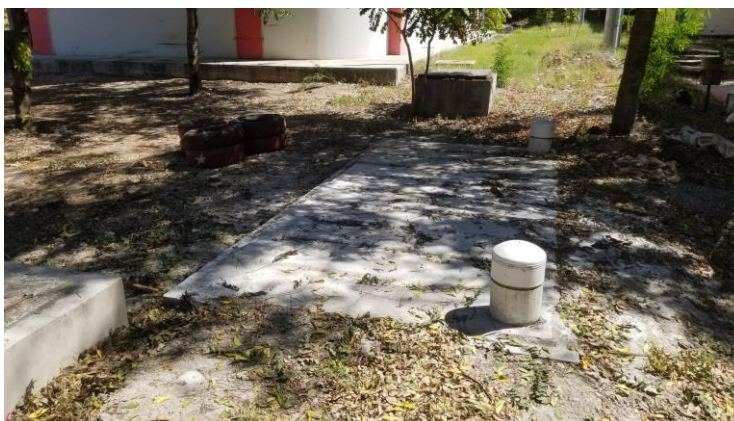
Fosa séptica del edificio de aulas de ingeniería
