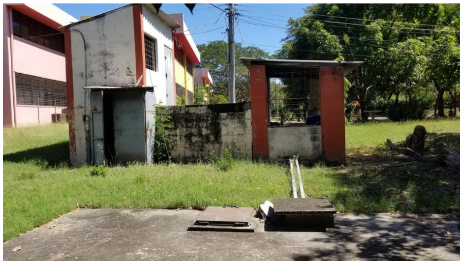
Cisterna y estación de bombeo de agua
