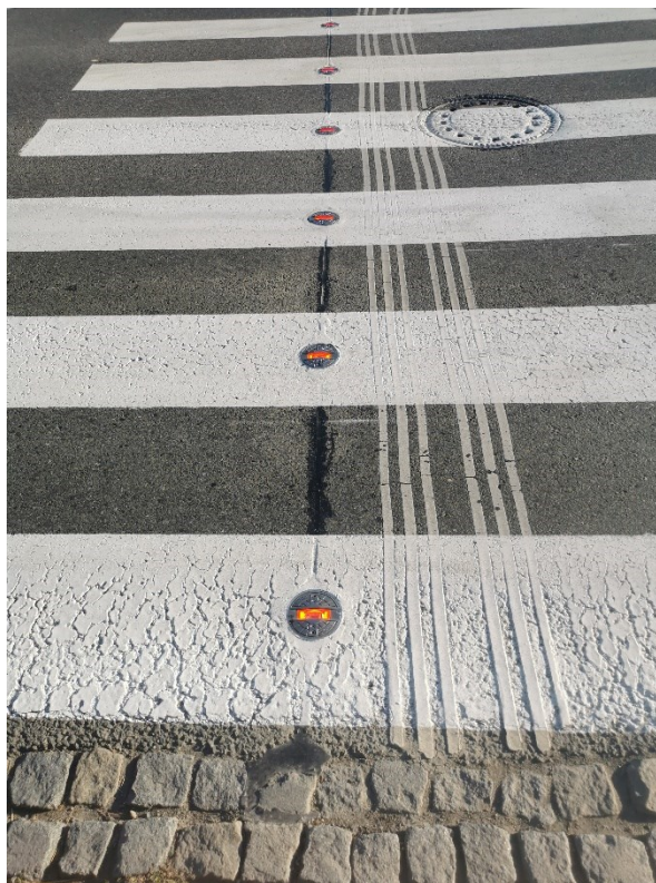
Obrázek 24 Světelná signalizace přechodu pro chodce Moravská
