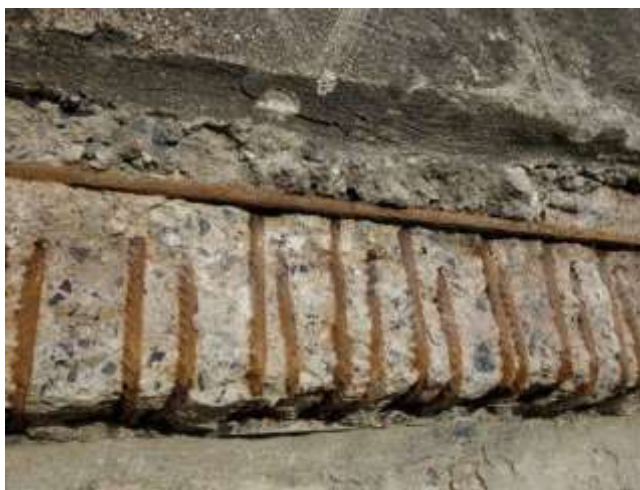
Obrázok 9 – Strata krycej vrstvy a korózia výstuže [22]
