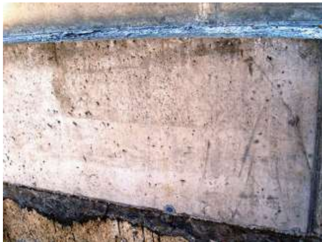
Obrázok 11 - Poškodenie betónu vplyvom mrazu [21]
