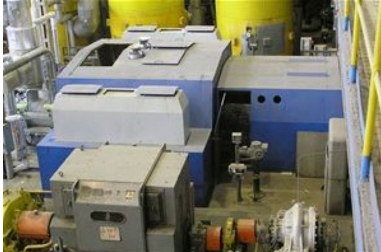
Obr. č. 3—1 Turbonapajčka elektrárny Dětmarovice [4]
