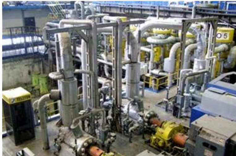
Obr. č. 3—2 Elektronapajčky elektrárny Dětmarovice [4]
