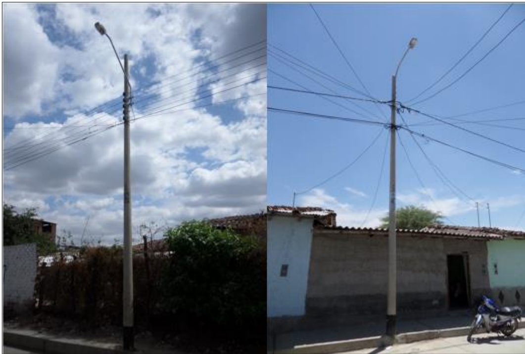
Figura 31: Redes de Distribución de Baja Tensión, Chulucanas.
