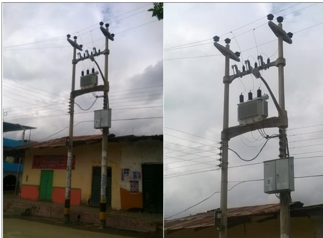
Figura 32: Subestaciones de Distribución, Chulucanas.
