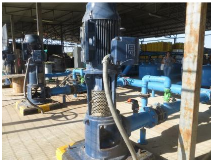
Foto N°06. Área de bombeo SANTA REGINA S.A.C.
