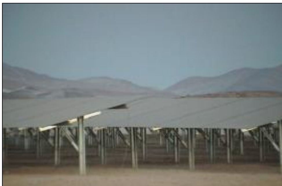
Figura 24: Vista de los paneles solares en C.S. Repartición
