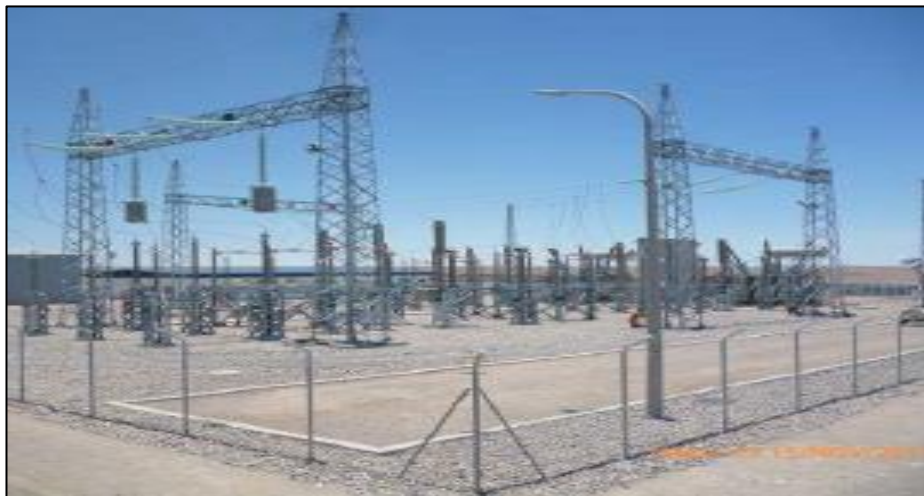
Figura 13: Subestación de la C.S. Rubí
