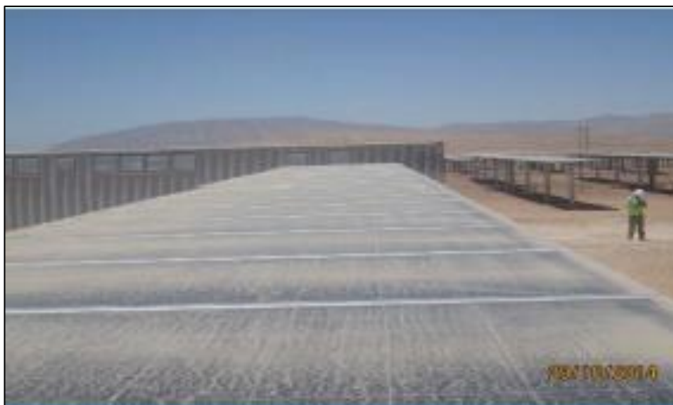
Figura 20: Vista de los paneles solares en C.S. Moquegua FV
