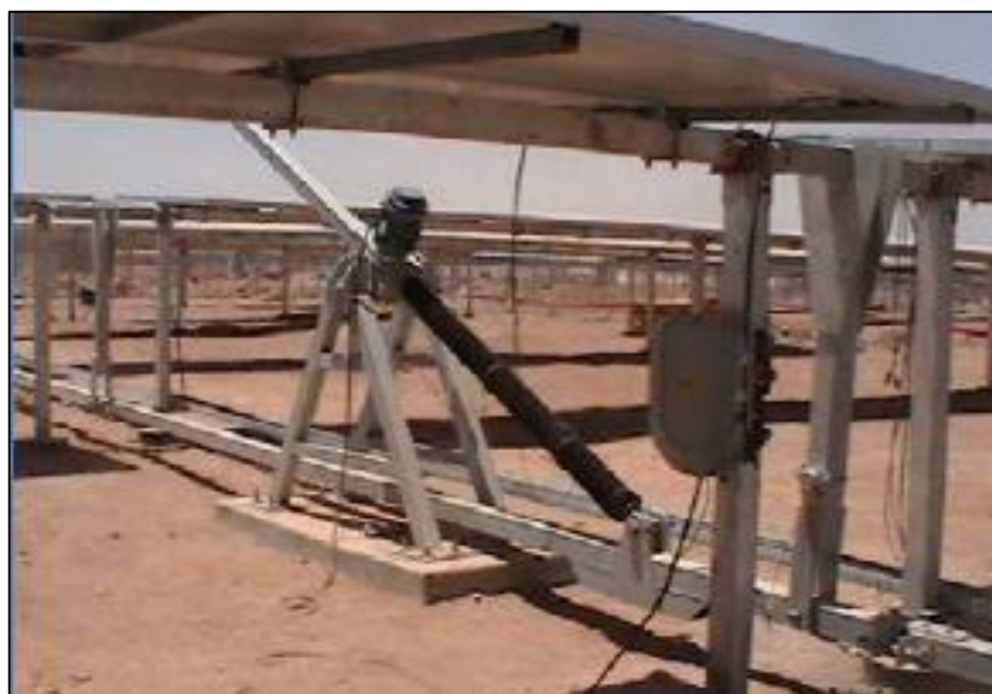
Figura 22: Vista de los paneles solares en C.S. Panamericana
