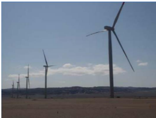
Figura 37: Vista de los aerogeneradores de la C.E. Wayra I
