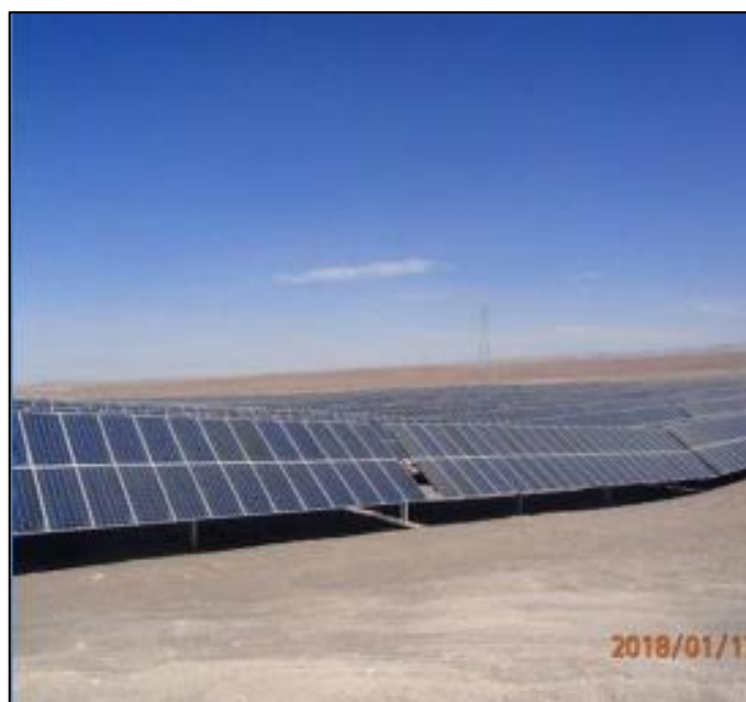
Figura 12: Vista de paneles solares de la C.S. Rubí
