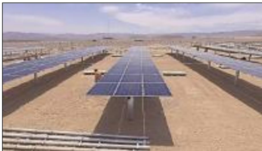
Figura 14: Vista de los paneles solares de la C.S. Intipampa
