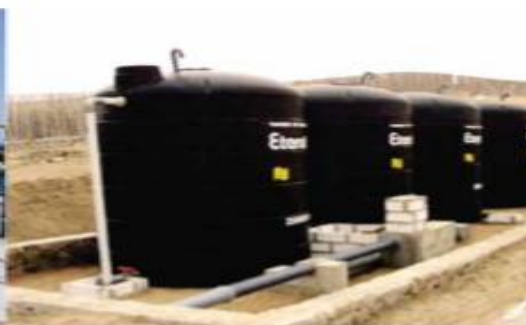
TRATAMIENTO DE AGUA
