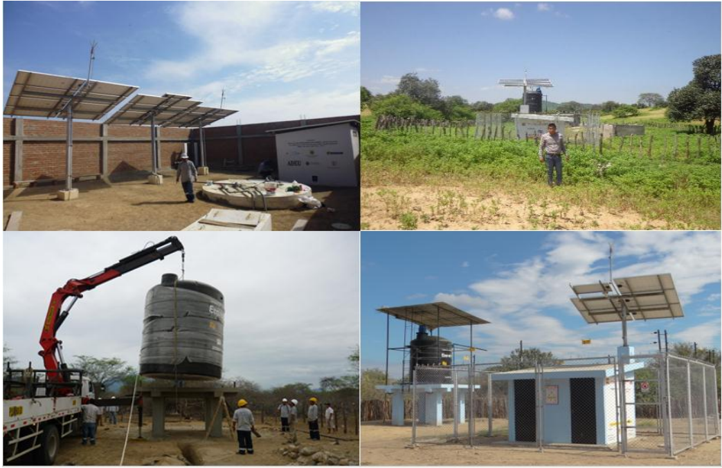
Fuente: Sistemas de bombeo Ternique – La Matanza.
