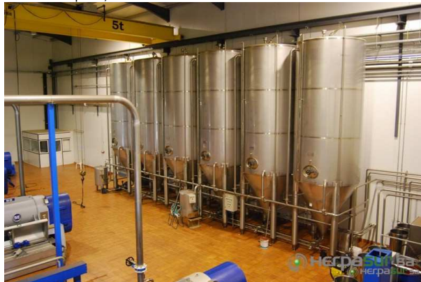
Figura 2.13 Depósitos instalados en una almazara
