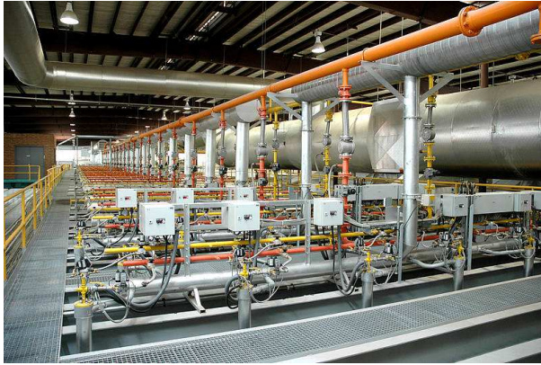
Figura 2.20 Vista superior de un horno túnel
