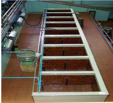
Figura 2.8 Batería de pozuelos de decantación
