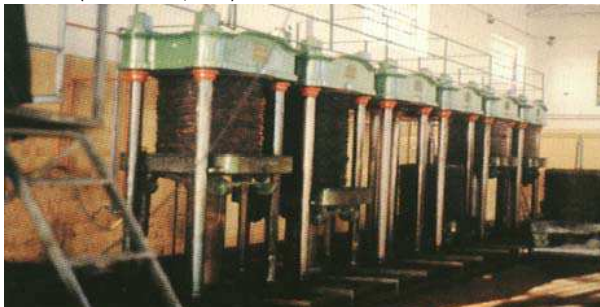
Figura 2.7 Prensas de extracción de aceite en funcionamiento
