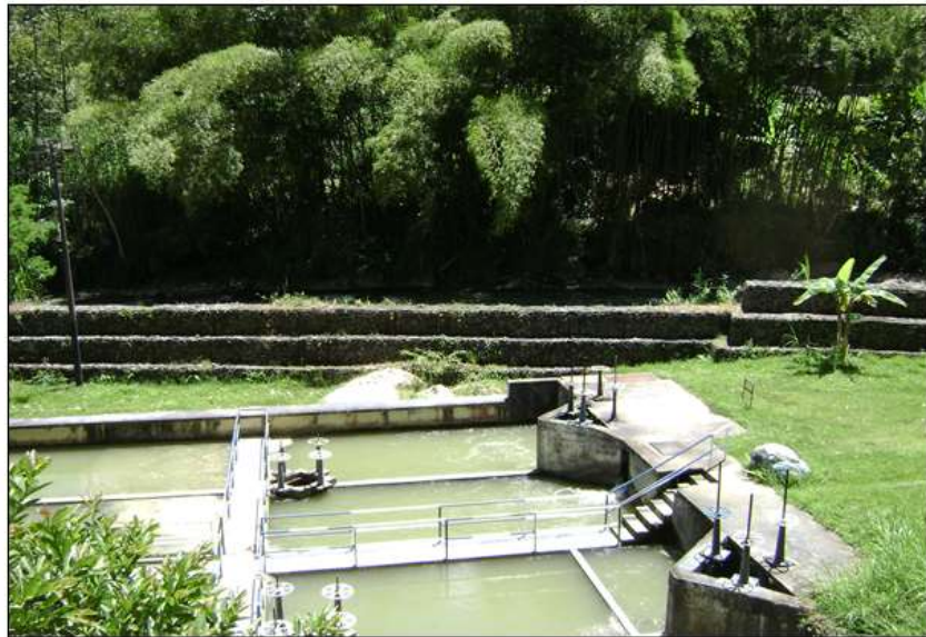
Figura 6. Tanques bocatoma acueducto de Ibagué.
