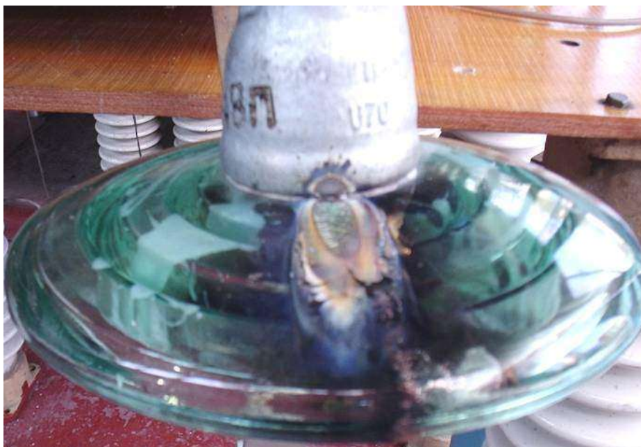
Результаты электротермического воздействия большого импульсного тока разрядной цепи генератора ГТМ на промышленный стеклянный подвесной изолятор
