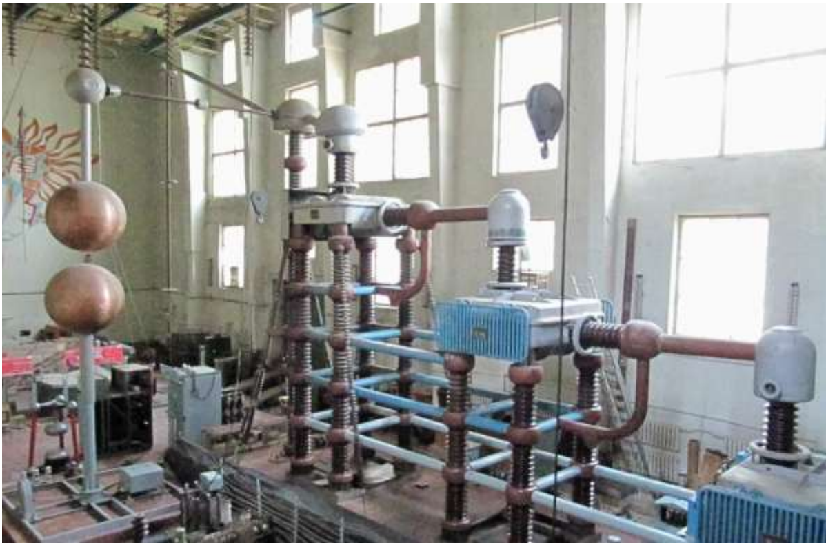
Большой высоковольтный зал НТУ «ХПИ»
