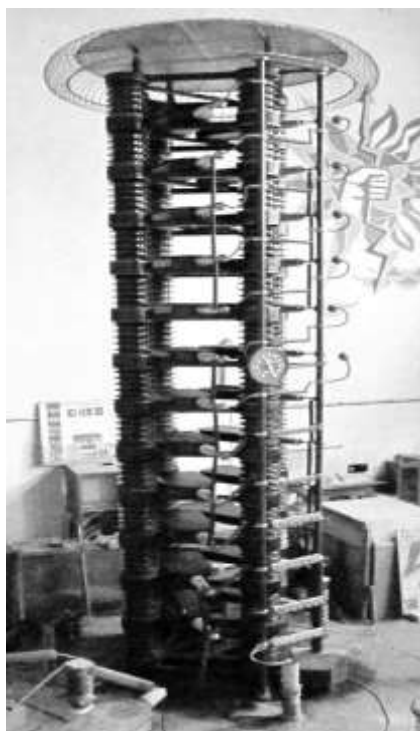
Действующий макет ГИН-2,5 для Запорожского трансформаторного завода в масштабе 1:2, большой высоковольтный зал ХПИ, г. Харьков
