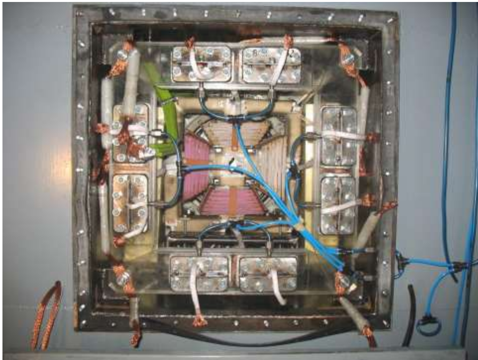
Трансформатор Тесла с крестообразным ферромагнитным магнитопроводом и коммутирующими искровыми разрядниками в мощной излучающей установке
