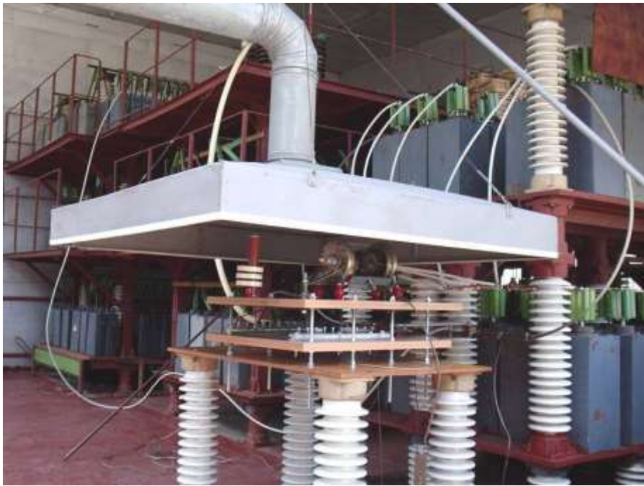
Общий вид мощного генератора тока искусственной молнии ГТМ (п. Андреевка Харьковской обл.), формирующего на электрической нагрузке многокомпонентный ток грозового разряда в соответствии с требованиями международных нормативно-технических документов
