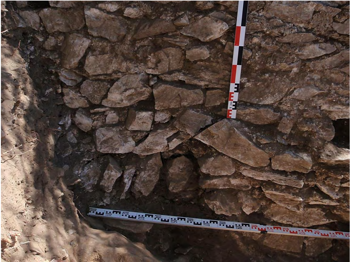
Fig. anomalie en sous-œuvre du M36
