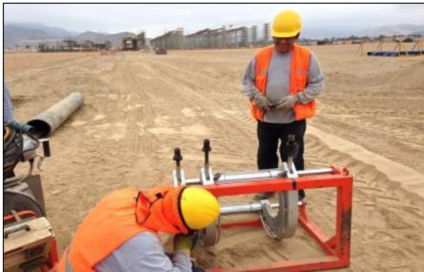
Figura 1. Instalación de líneas de agua y desagüe (500mm, 450mm, 400mm, 355mm, 315mm, 250mm, 160mm) – Corporación Lindley Nueva Planta Coca Cola km 62 Panamericana Sur.
