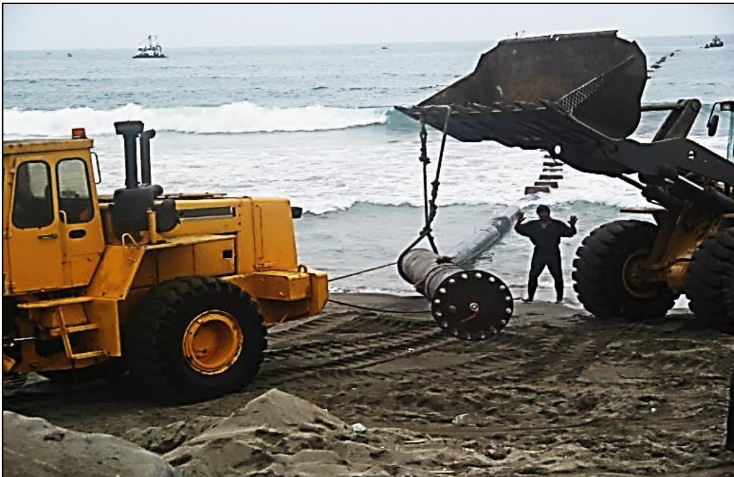
Figura 5. Instalación de línea HDPE 4Km.en tierra y lanzamiento marino de 1,856 Mt. Mar. – Calsas Grupo Fleischman.
