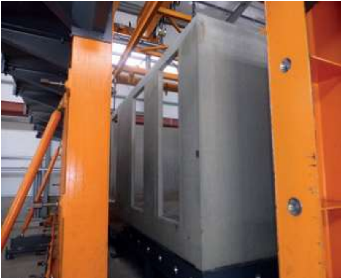
Figura 44. Tras retirar el «núcleo contraíble» ya se puede abrir el encofrado exterior. Fuente: http://revistapyc.com .
