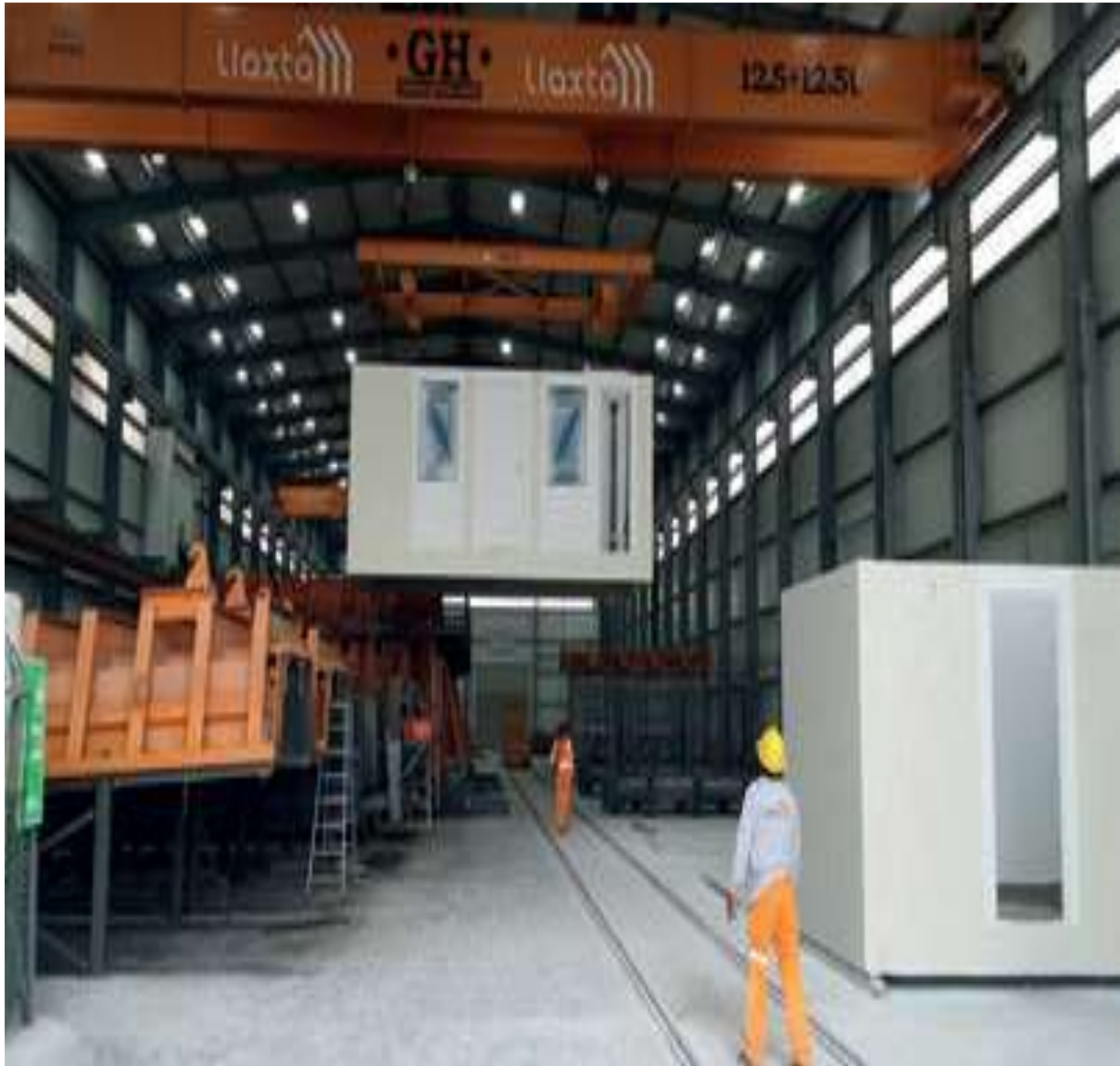
Figura 47. Con la ayuda de travesaños especiales y una grúa de 12,5 t, el módulo de ambiente es transportado para su procesamiento posterior. Fuente: http://revistapyc.com .
