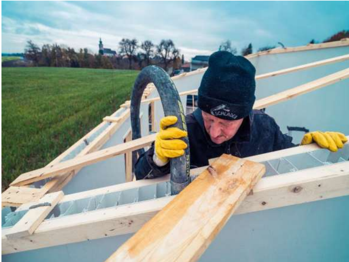
Figura 80. Los perfiles de pared se rellenan con concreto (a través de una bomba o de forma manual con cubetas. Fuente: https://docplayer.es/15263402-Ghs-permanent-home-otorgamos-un-hogar-a-las-personas-rapido-seguro-simple.html )
