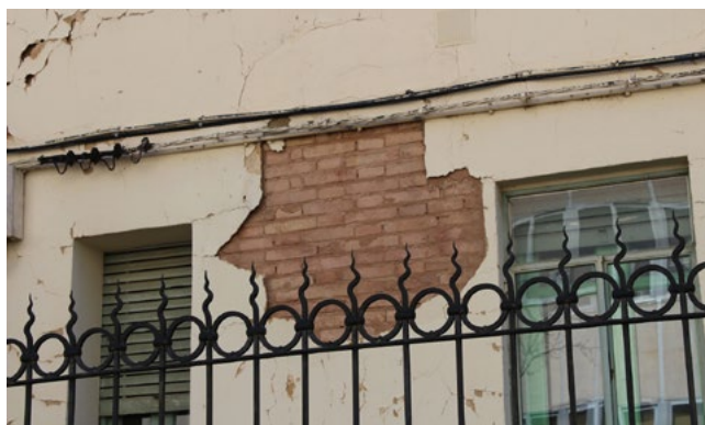
Figura 6. Desperfectos en el revestimiento del edificio situado en la calle San Vicente de Paúl 6.
