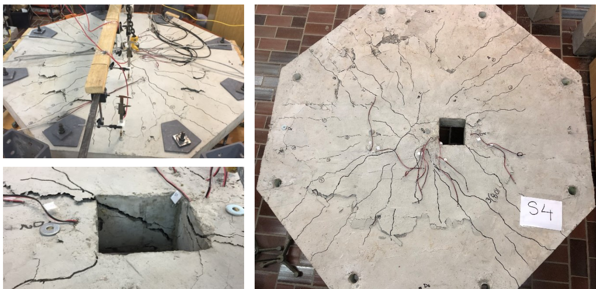
Slika 90: Raspored prsline na zategnutoj površini ploče S4
