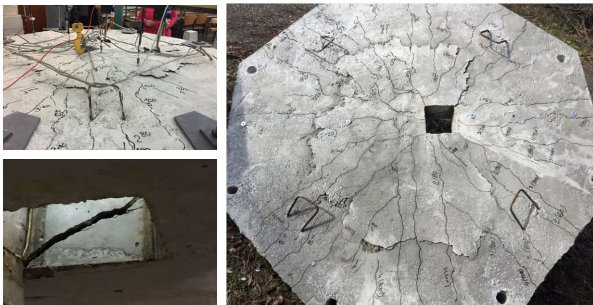
Slika 88: Raspored prslina na zategnutoj površini ploče S3
