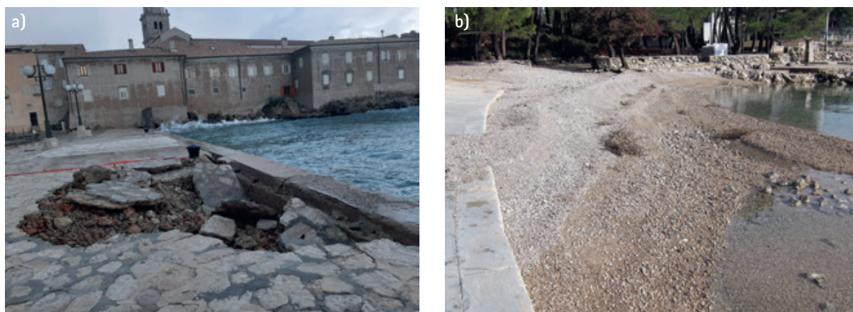
Slika 13: a) oštećena Vela riva na obali grada Krka; b) razoreno žalo u uvali Plav kod grada Krka.
