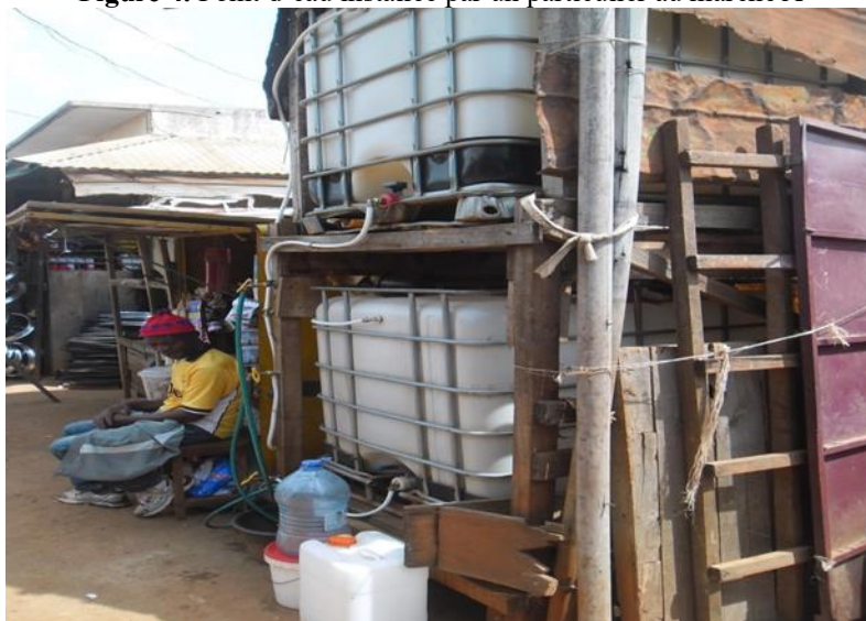
Figure 4. Point d'eau installée par un particulier au marché A
