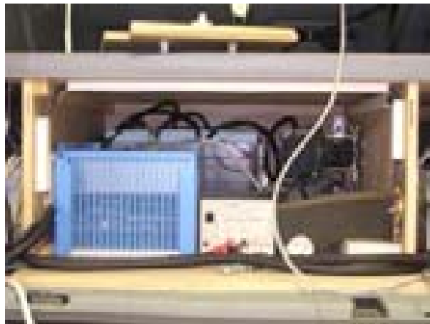
FIG. C.3: L'onduleur et les batteries
