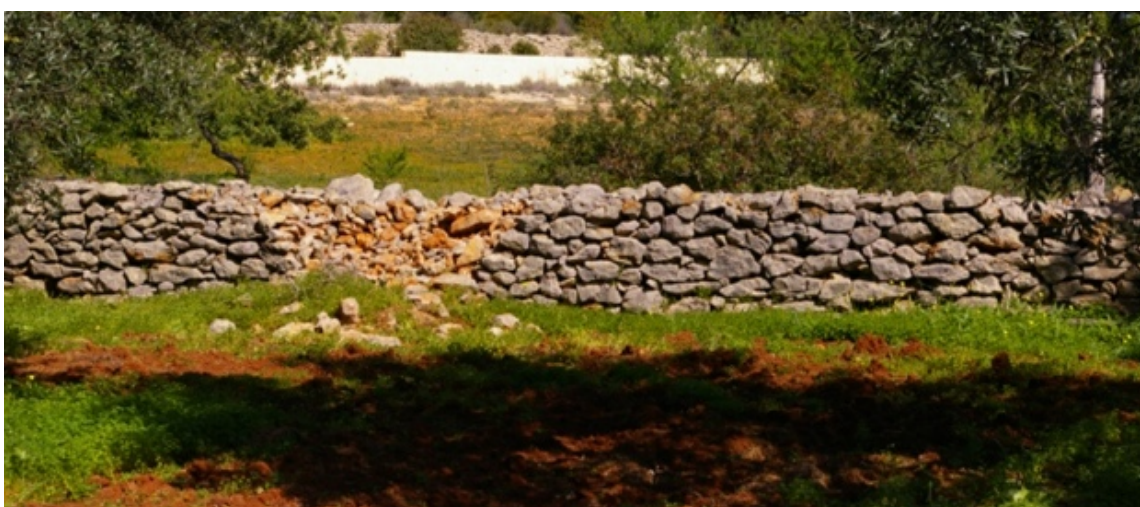
Figura 8.1.6. - Muro com parte da estrutura em mau estado, ponto de visita nº 53
