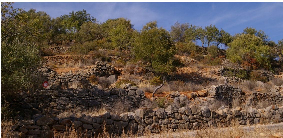
Figura 8.1.4. – Muro em mau estado associados a socacos, ponto de visita nº15
