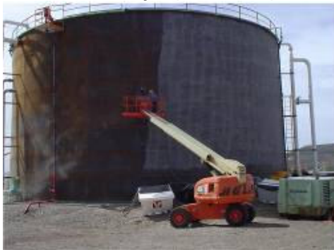
Área de arenado a 5 mts de distancia del tanque (Medición 3)
