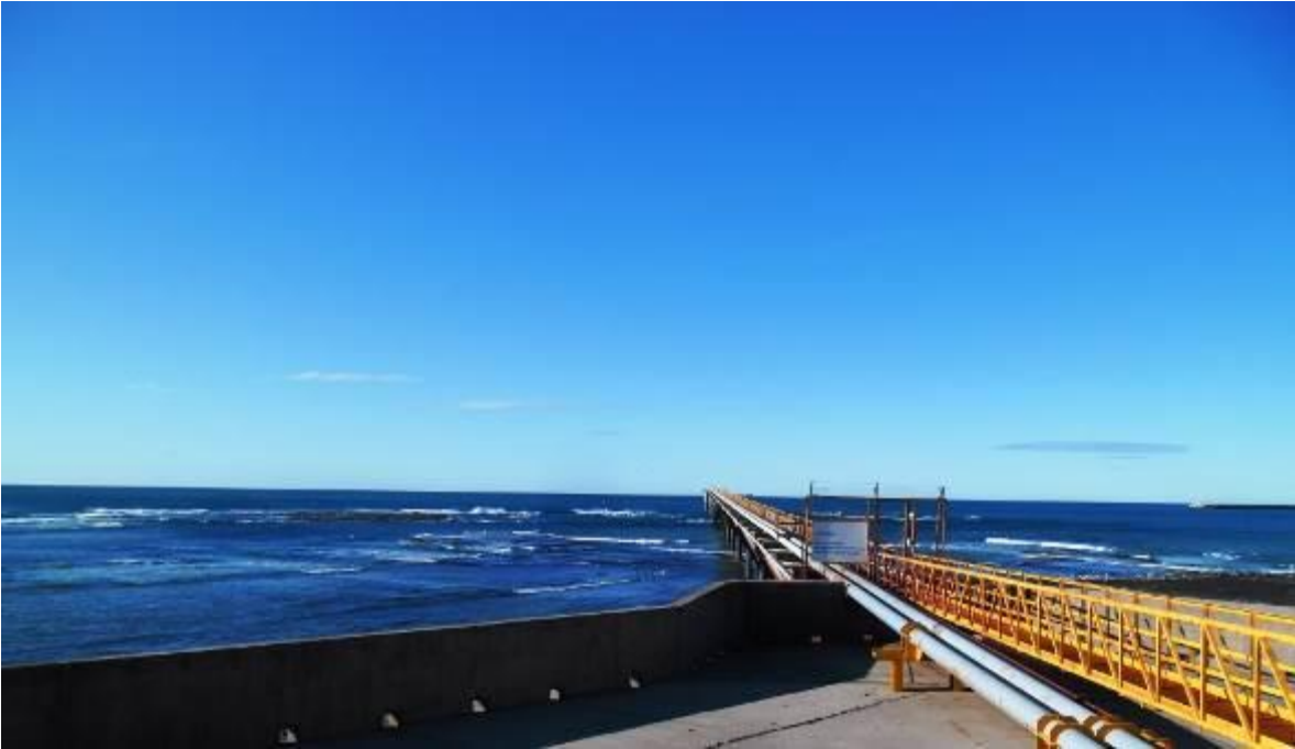
Espigón y senda de cañerías de recepción (vista a nivel de piso).
