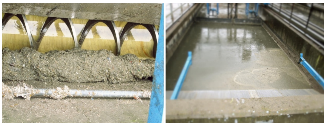
Figura 2.2 Trampa de grasas EDAR
