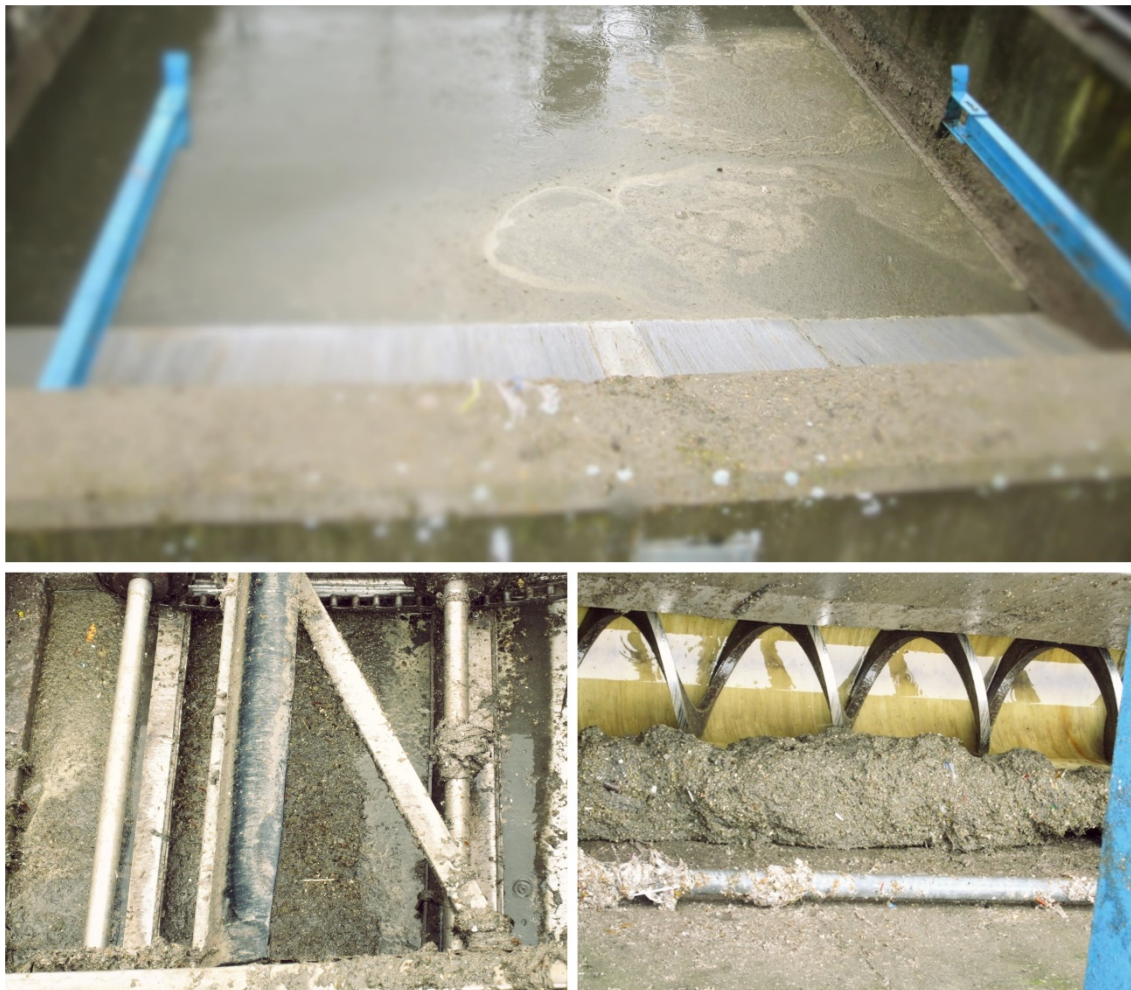
Figura 3.4 Separación del FOG en trampa de grasas
