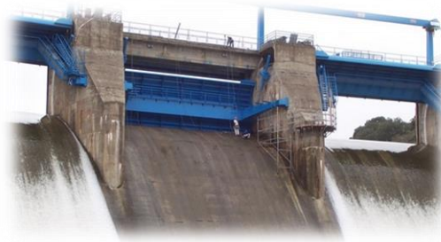
Figura 5.18 Compuertas presa de Águeda (Salamanca).
