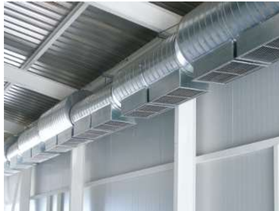
Figura 3.8.- Tubería chapa metálica
