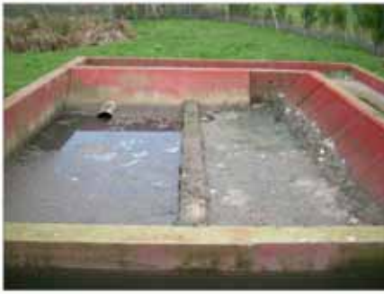
Punto 1 de muestreo de agua. Entrada de agua residual a la instalación.
