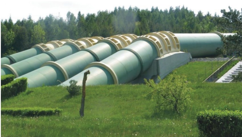
Rycina 43. Rurociągi w EW Żarnowiec (fot. B. Igliński)
