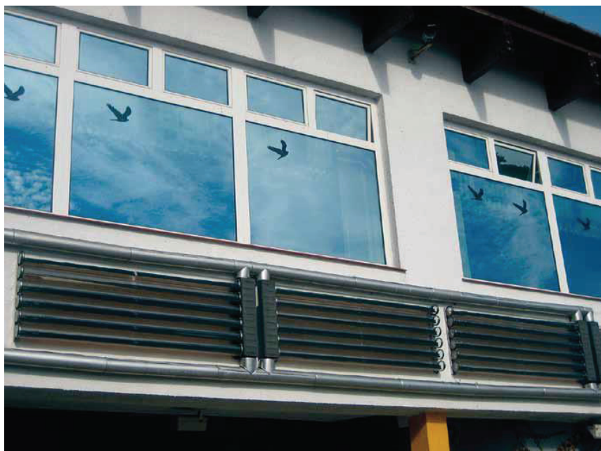
Rycina 52. Kolektory rurowe na Ośrodku Edukacji Ekologicznej „Wilga” w Górznie (fot. R. Koj)
