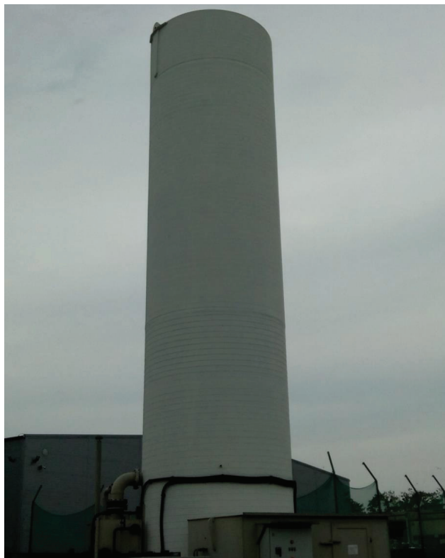
Rycina 15. Kolumna ze złożem biologicznym do odsiarczania biogazu (fot. B. Igliński)
