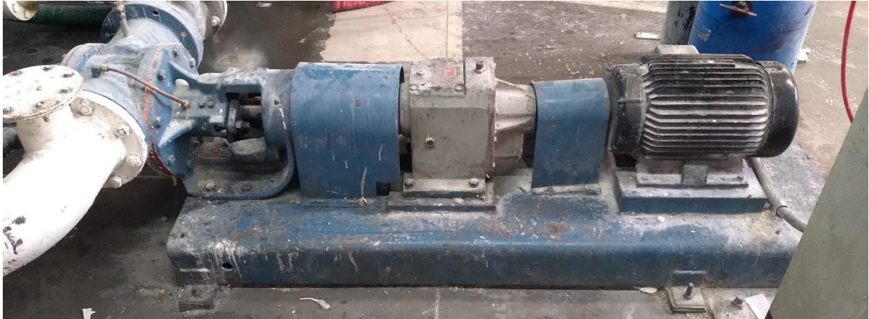
Figura 2.3. Equipo de bombeo del Plastisol hacia los tanques de almacenamiento.
