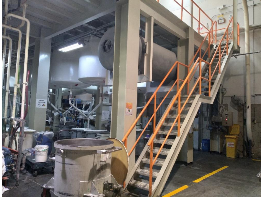
Figura 1.2. Sección inferior de los tanques de almacenamiento del Plastisol.
