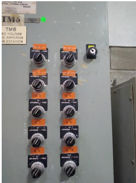
Figura 1.4. Interruptores para el encendido de los motores de los tanques.
