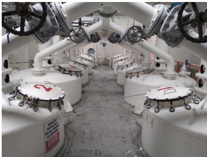
Figura 1.1. Sección superior de los tanques de almacenamiento del Plastisol.
