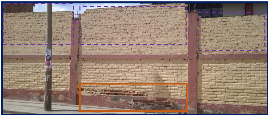
FOTOGRAFÍA N° 03- Se aprecia las patologías de eflorescencia, suciedad, corrosión y erosión en el Cerco Perimétrico de la I.E.P. Virgen del Carmen N° 32002.
