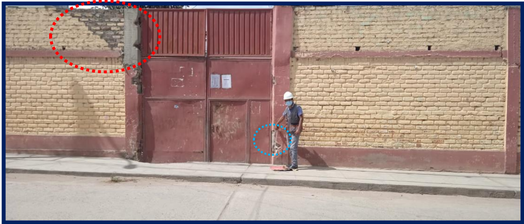
FOTOGRAFÍA N° 01- Se aprecia la medición de las patologías de desprendimiento, grieta fisuras y suciedad en el Cerco Perimétrico de la I.E.P. Virgen del Carmen N° 32002.
