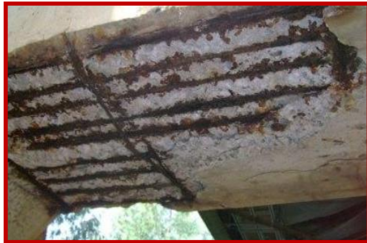
Figura N° 30: Ataques por corrosión
