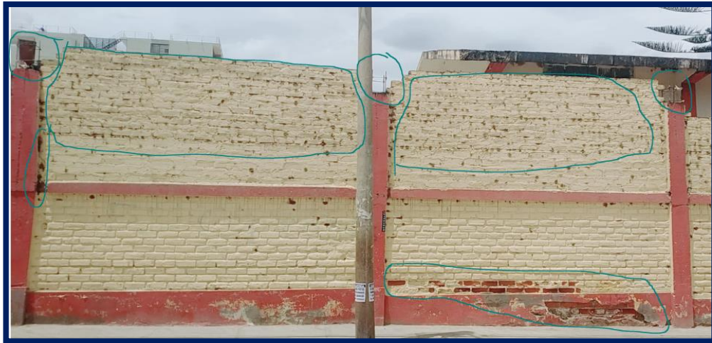
FOTOGRAFÍA N° 08- Se aprecia las patologías de grieta, suciedad, corrosión, eflorescencia y erosión en el Cerco Perimétrico de la I.E.P. Virgen del Carmen N° 32002.
