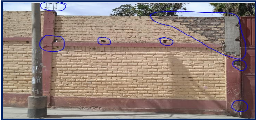
FOTOGRAFÍA N° 05- Se aprecia las patologías de grieta, desprendimiento, corrosión, fisura y erosión en el Cerco Perimétrico de la I.E.P. Virgen del Carmen N° 32002.
