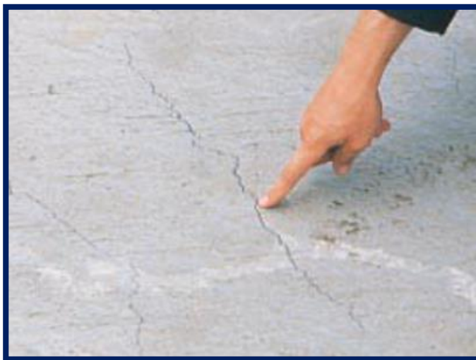
Figura N° 13: Fisuras por cambio de humedad
