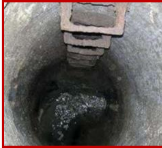
Figura N° 26: Ataques por agua de desagüe
