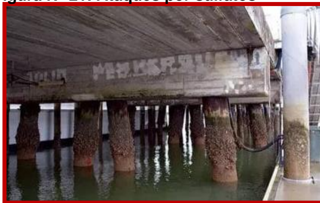
Figura N° 21: Ataques por sulfatos
