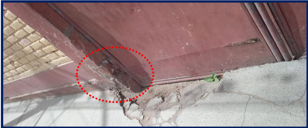
FOTOGRAFÍA N° 02- Se aprecia la patología de grieta en la columna de amarre del Cerco Perimétrico de la I.E.P. Virgen del Carmen N° 32002.
