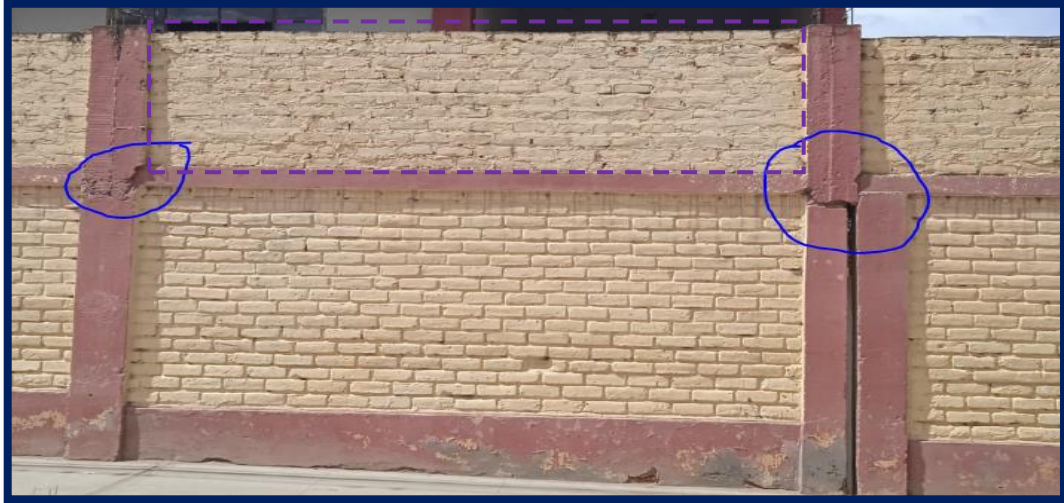
FOTOGRAFÍA N° 04- Se aprecia las patologías de grieta, fisura y erosión en el Cerco Perimétrico de la I.E.P. Virgen del Carmen N° 32002.
