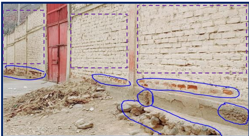
FOTOGRAFÍA N° 06- Se aprecia las patologías de eflorescencia, erosión, suciedad, grieta y fisuras en el Cerco Perimétrico de la I.E.P. Virgen del Carmen N° 32002.
