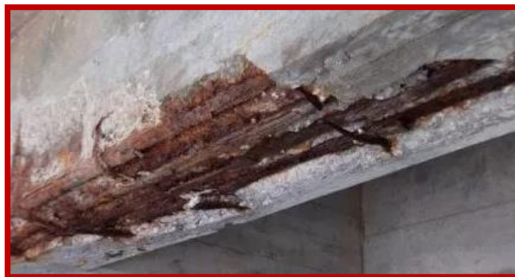
Figura N° 22: Ataques por cloruros
