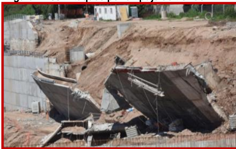
Figura N° 33: Ataques por empuje de tierras
