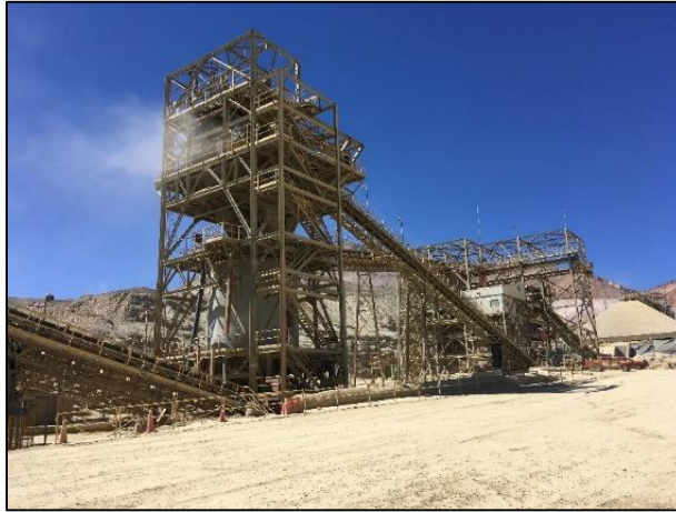
Fotografía 1. Chancadores primario y secundario.
