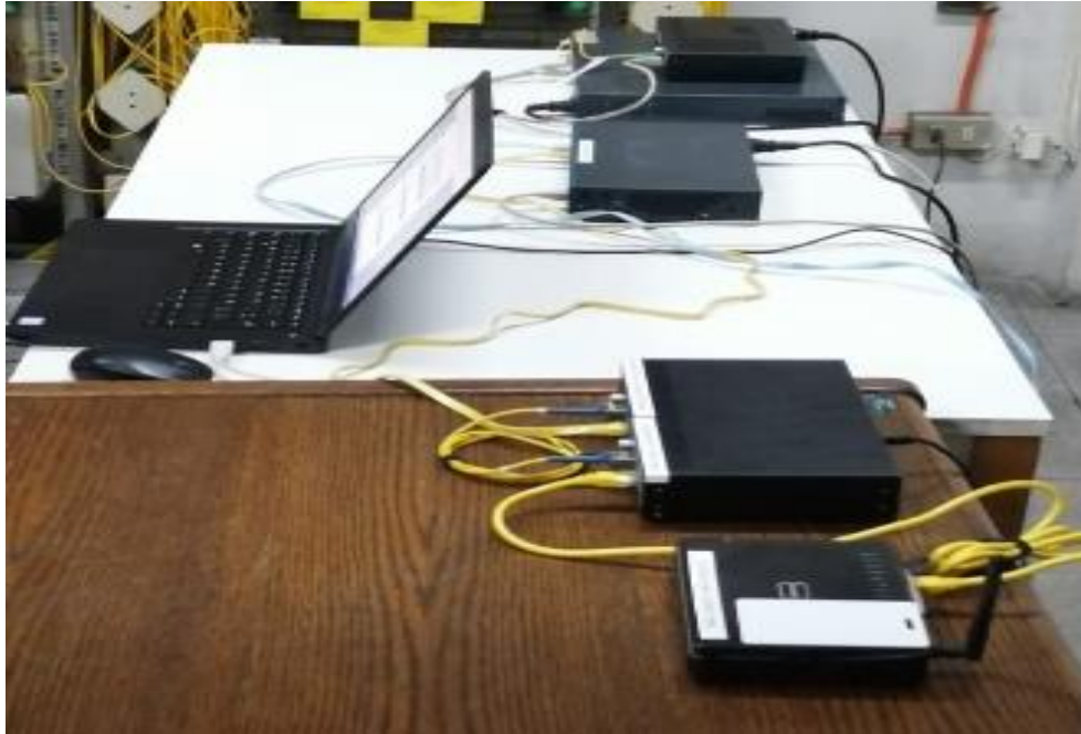
Ilustración 77 – Conversores de medios ISP y cliente final (Elaboración propia, 2019).
