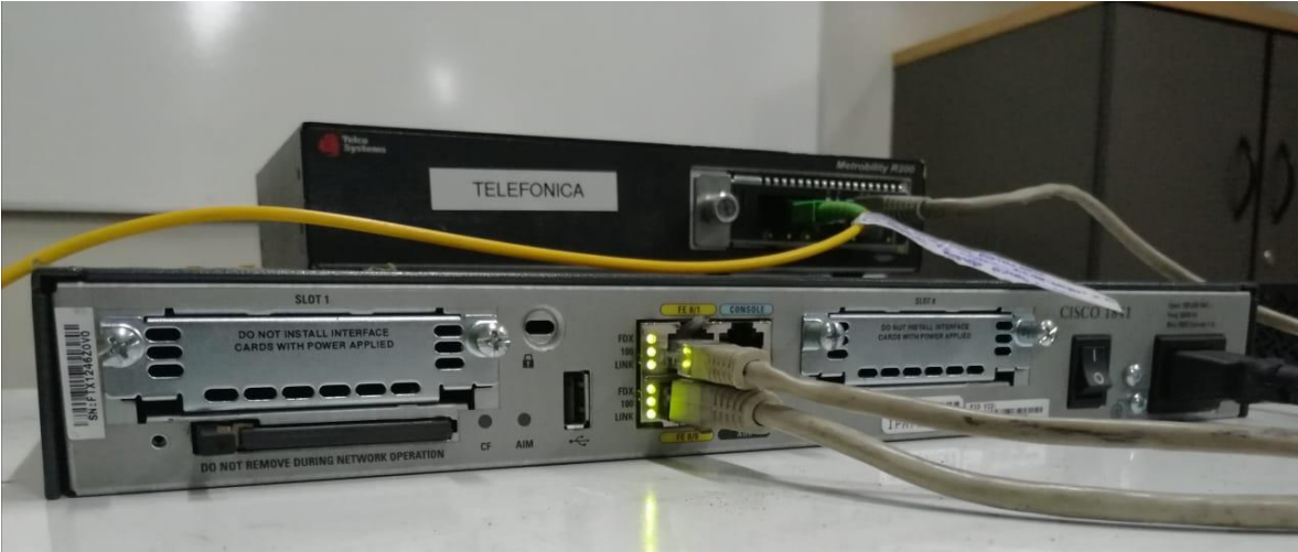
Ilustración 75 – Router y Conversor de medios Movistar (Elaboración propia, 2019).
