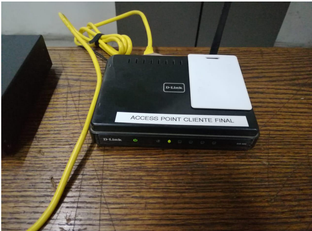
Ilustración 78 – Access point cliente final (Elaboración propia, 2019).
