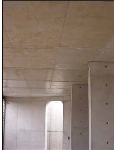
Foto 33.- Oxidación en la parte inferior de la losa
