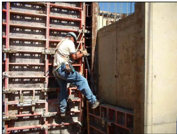
Foto 35.- Desmoldando en forma indebida con un chuzo
