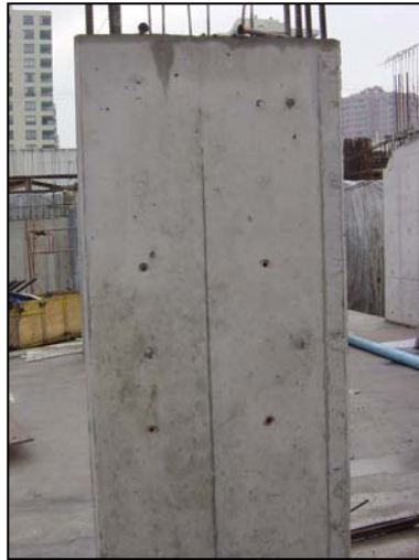
Foto 4.- Líneas marcadas por la falta de estanqueidad
