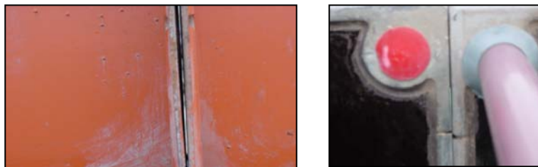
Foto 2,3.- Mala junta de los bastidores
