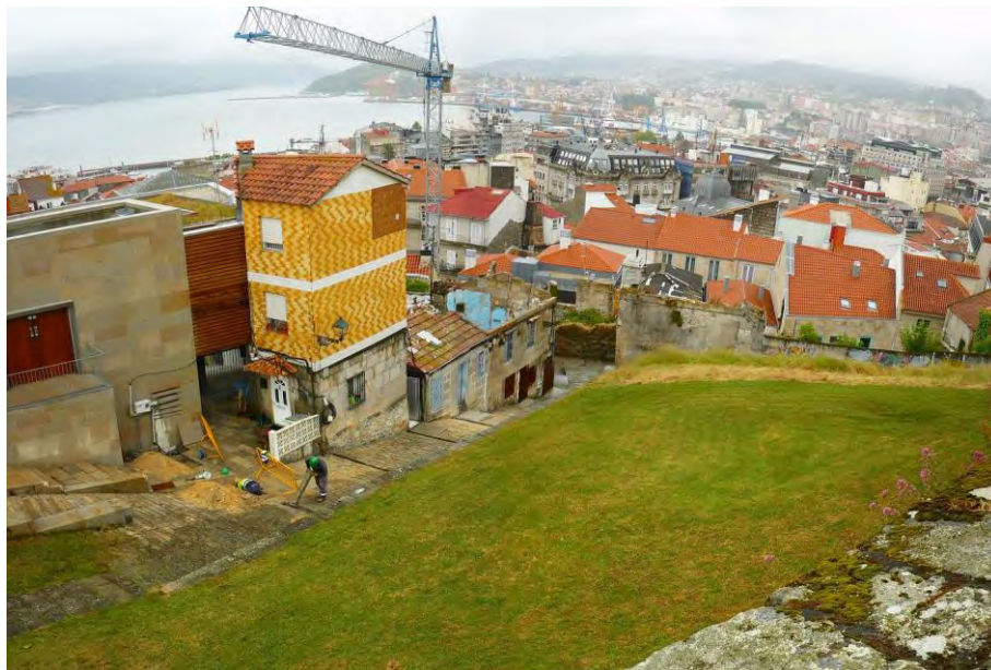
Figura 6. Vista das obras na rúa Hortas, dende o Castelo de San Sebastián.
