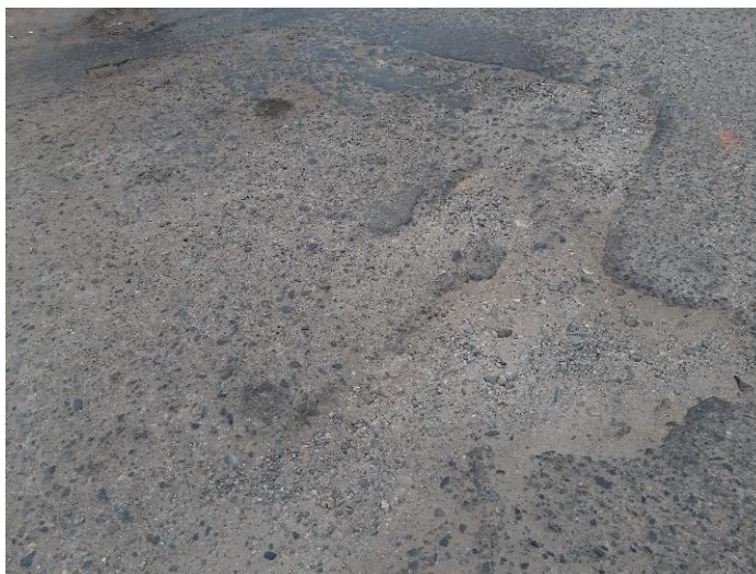
Figura N° 13: Desprendimiento de agregados
