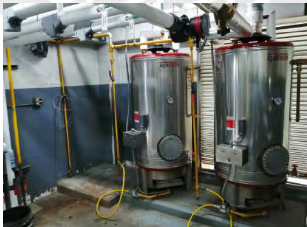
figura: 9 Visualización real de las 2 termas ubicadas en el cuarto de máquinas.
