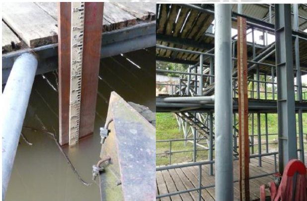
Figura 24. Estación de medición
