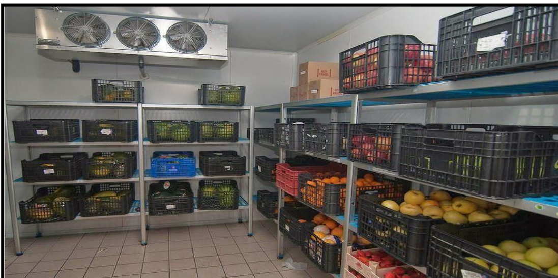
Figura 10: Almacenamiento de insumos en frío Fuente: La empresa
