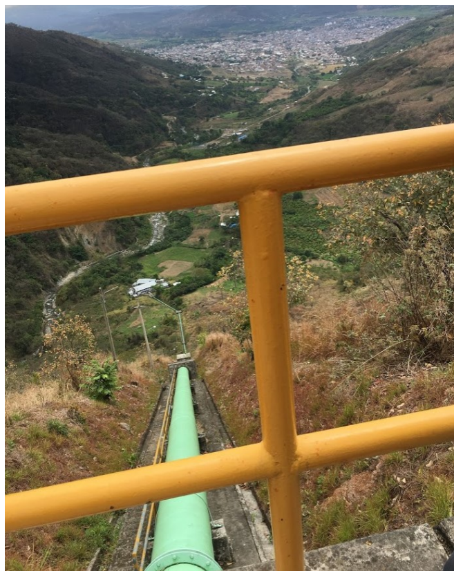
FOTOGRAFÍA N°5.32: Caída de la tubería de la hidroeléctrica La Pelota.
