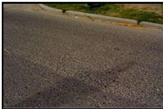
Fig. 22. Desprendimiento de Agregados.
