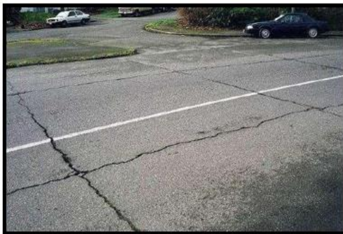
Fig. 9. Grietas de reflexión de juntas
