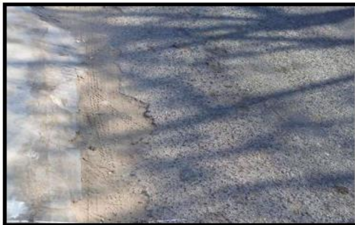
Fig. 8. Fisuras de borde.
