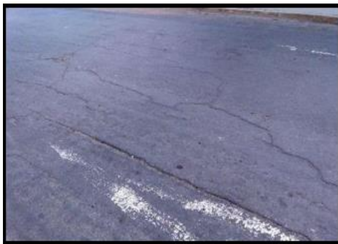
Fig. 3. Agrietamiento en Bloque
