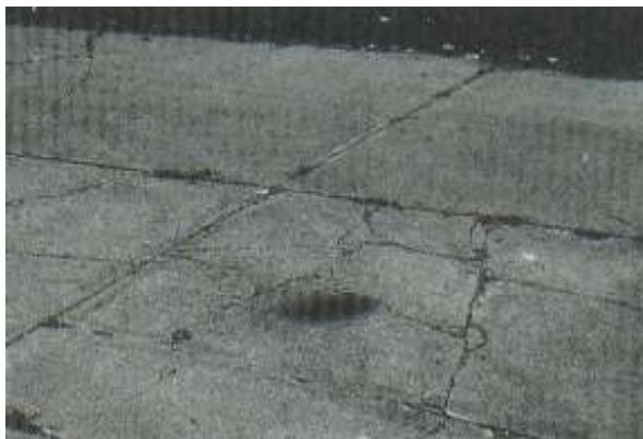
Ilustración 71: Losa dividida de severidad alta
