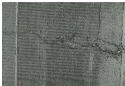
Ilustración 35: Grieta de reflexión de junta de media severidad
