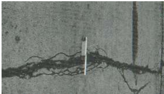
Ilustración 36: Grieta de reflexión de junta de Alta severidad
