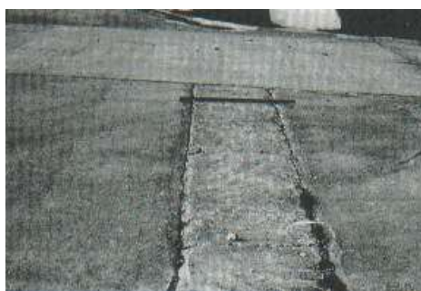
Ilustración 88: Parche grande y acometidas de servicios públicos de media severidad
