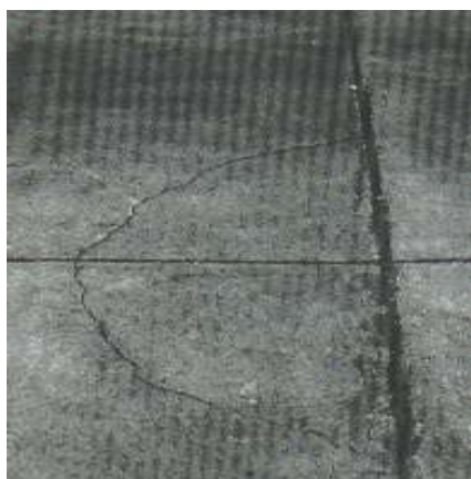
Ilustración 66: Grieta de esquina de severidad baja
