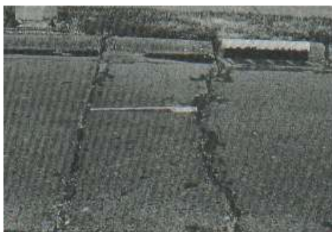
Ilustración 96: Punzonamiento de baja severidad
