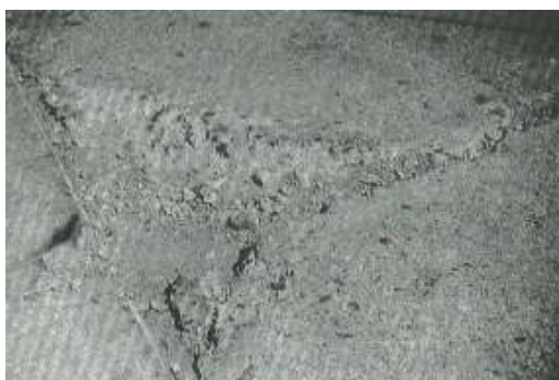
Ilustración 105: Descascaramiento de alta severidad
