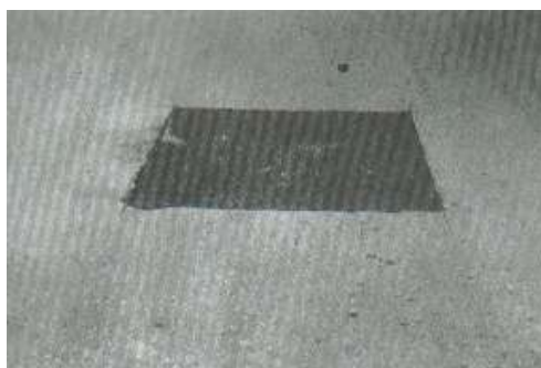
Ilustración 43: Parcheo y acometidas de servicios públicos de Severidad baja
