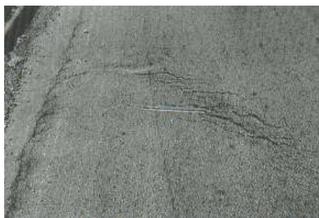
Ilustración 57: Grietas parabólicas de severidad media
