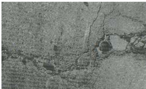
Ilustración 42: Grietas longitudinales y transversales de Severidad alta
