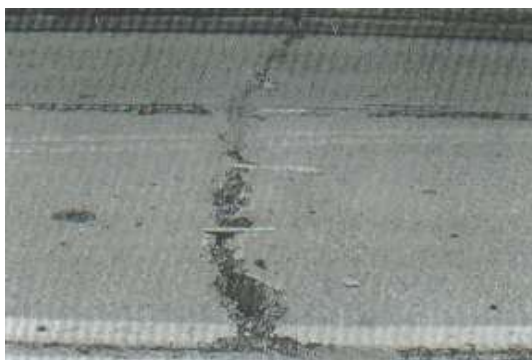
Ilustración 86: Grietas lineales de alta severidad
