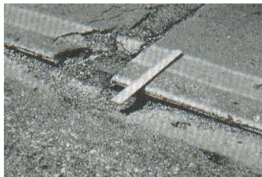
Ilustración 81: Desnivel carril/berma de baja severidad
