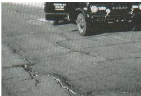
Ilustración 21: Agrietamiento en Bloque Nivel Alto
