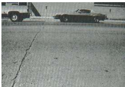
Ilustración 106: Descascaramiento de baja severidad
