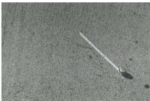
Ilustración 56: Grietas parabólicas de severidad baja
