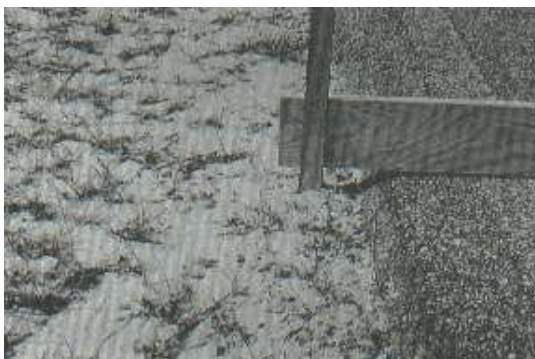
Ilustración 37: Desnivel Carril/Berma de Baja severidad
