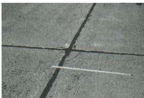
Ilustración 103: Descascaramiento de baja severidad
