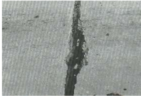
Ilustración 79: Daño del sello de la junta de media severidad
