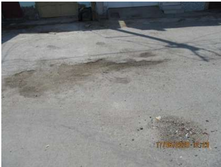
Daños encontrados en el pavimento flexible
