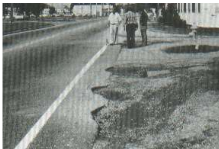
Ilustración 33: Grieta de borde de severidad alta
