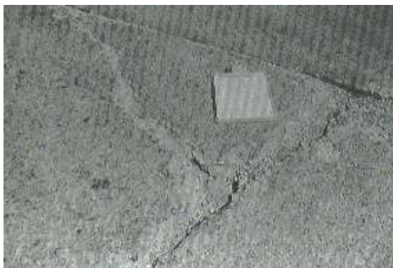
Ilustración 68: Grieta de esquina de severidad alta
