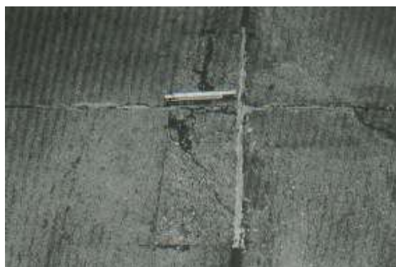
Ilustración 92: Parche pequeño de alta severidad
