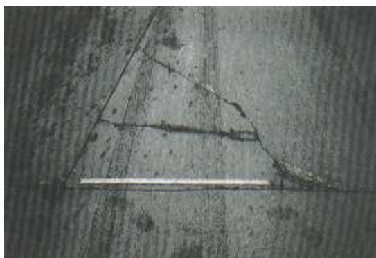
Ilustración 67: Grieta de esquina de severidad media
