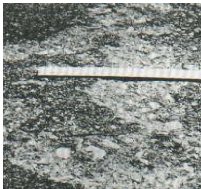
Ilustración 100: Desconchamiento, mapa de grietas, craqueado de media severidad
