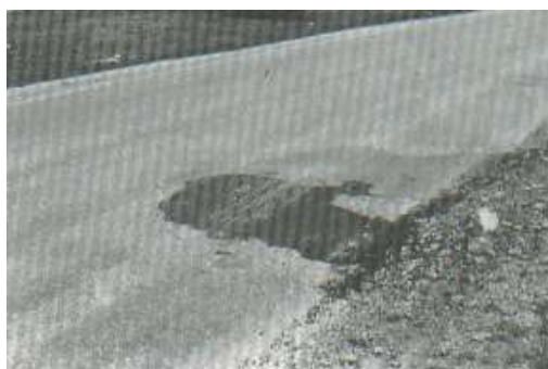
Ilustración 44: Parcheo y acometidas de servicios públicos de Severidad media
