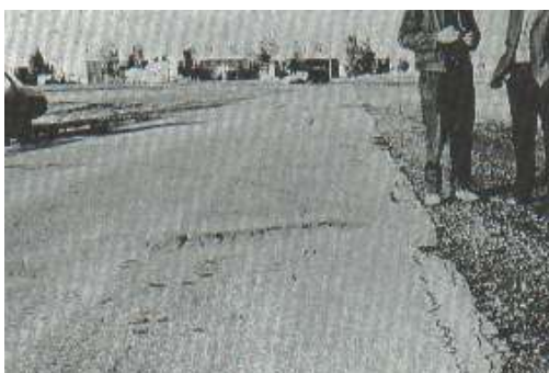
Ilustración 23: Abultamientos y hundimientos de severidad media
