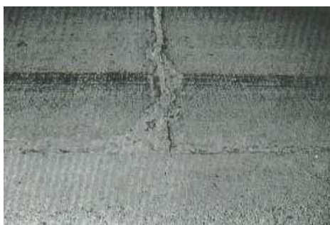
Ilustración 104: Descascaramiento de media severidad
