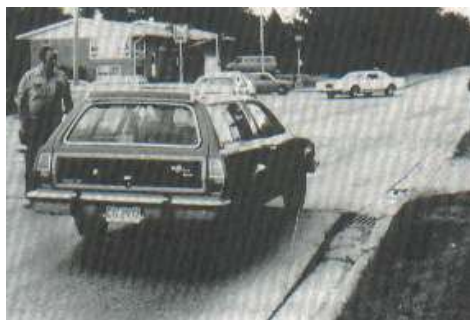
Ilustración 65: Blowup – Buckling de severidad alta
