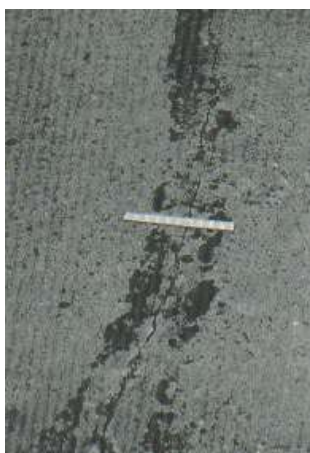
Ilustración 84: Grietas lineales de baja severidad
