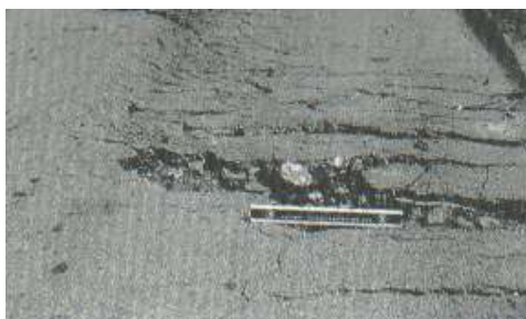
Ilustración 58: Grietas parabólicas de severidad alta
