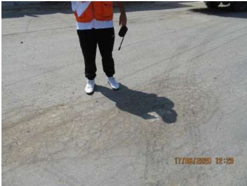
Daños encontrados en el pavimento flexible
