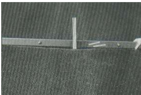
Ilustración 51: Ahuellamiento de Severidad media
