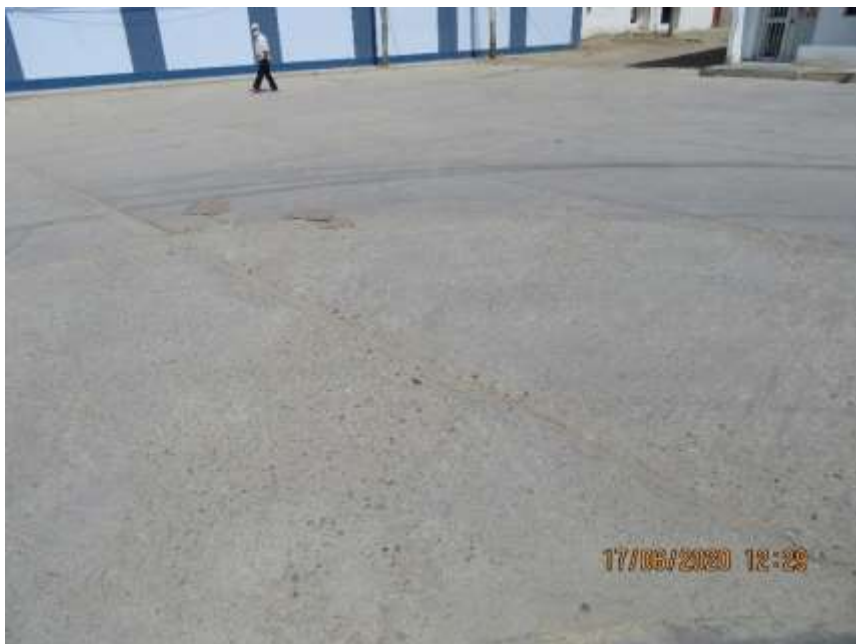
Vista panorámica de los daños encontrados en el pavimento rígido
