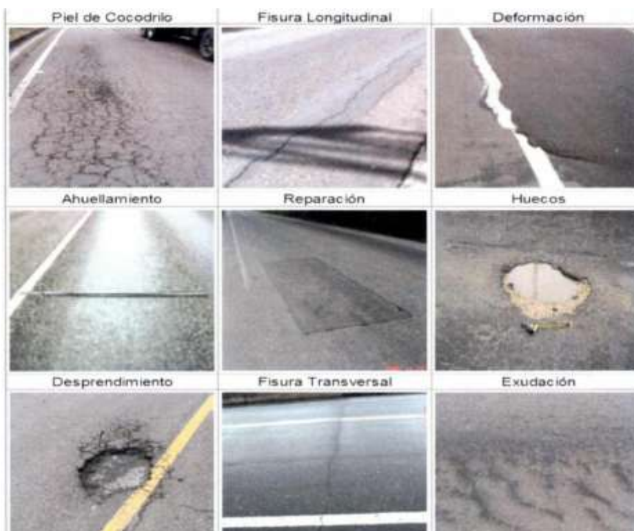
Ilustración 109: Daños en pavimentos flexibles
