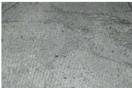
Ilustración 74: Grietas de durabilidad “D” de alta severidad
