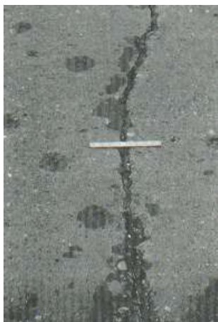
Ilustración 85: Grietas lineales de media severidad
