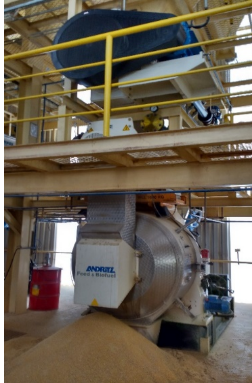
Fig.6. Conjunto Acondicionador + Granuladora ANDRITZ en una parada por bloqueo de pienso en la matriz (Frango Rico – Brasil)
