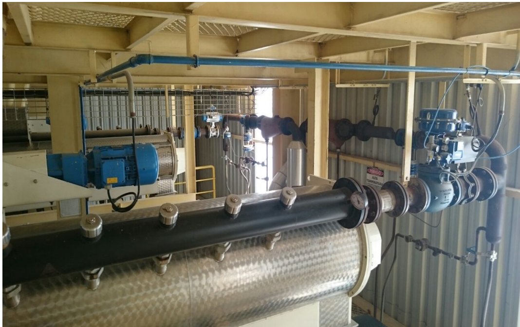
Fig.5. Conjunto Acondicionador ANDRITZ + línea de Vapor Spyrax Sarco (Frango Rico – Brasil)
