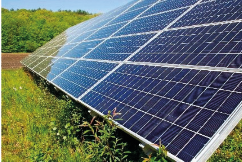
Figura 141. Dispositius solars fotovoltaics
