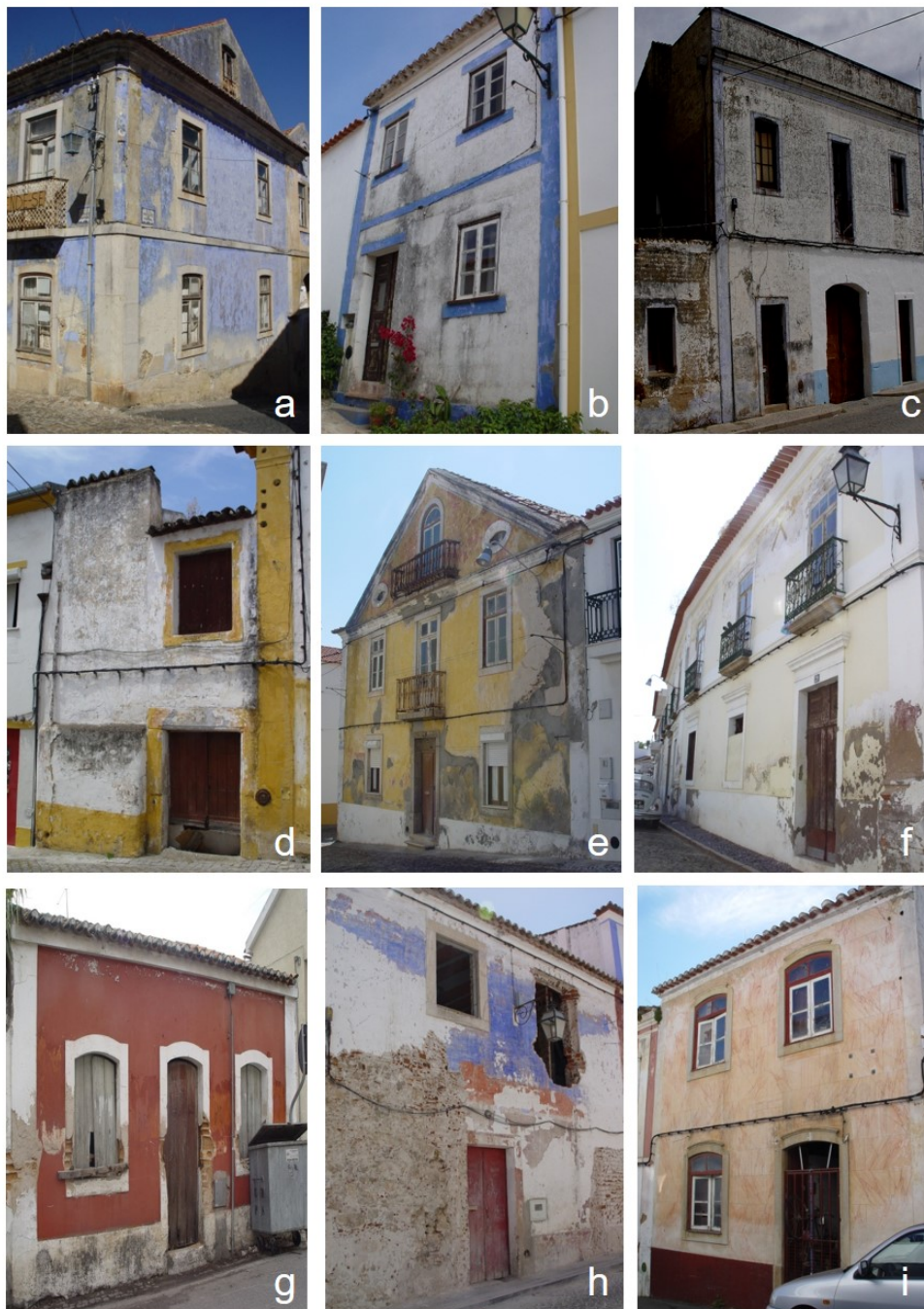
Figura 1. Exemplos de pinturas a cal no Património Edificado Português no Alentejo [17]: (a) Santiago do Cacém; (b) Odemira; (c) Grândola; (d) Crato; (e) Sines; (f) Moura; (g) Ponte de Sôr; (h) Arraiolos; (i) Almodôvar.
