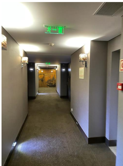
Figura 22 Blocos autónomos no corredor do piso 2 com a indicação da saída de emergência.
