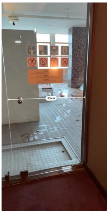
Figura 16 Porta de acesso à área da piscina, sauna, jacuzzi e banho tuco.
