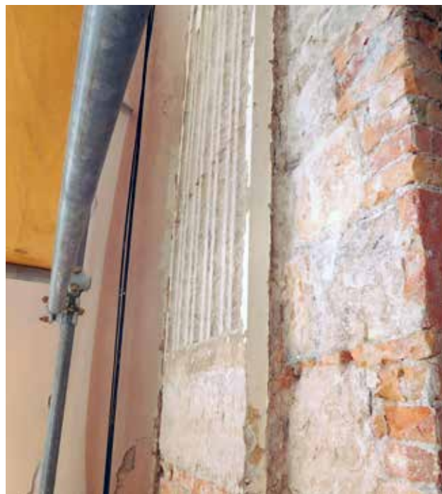
12 Donji dio pilastra otkriven pod recentnim slojem žbuke; baza modelirana na istaknutim redovima opeke je otučena (foto: S. Buble, 2019.).
