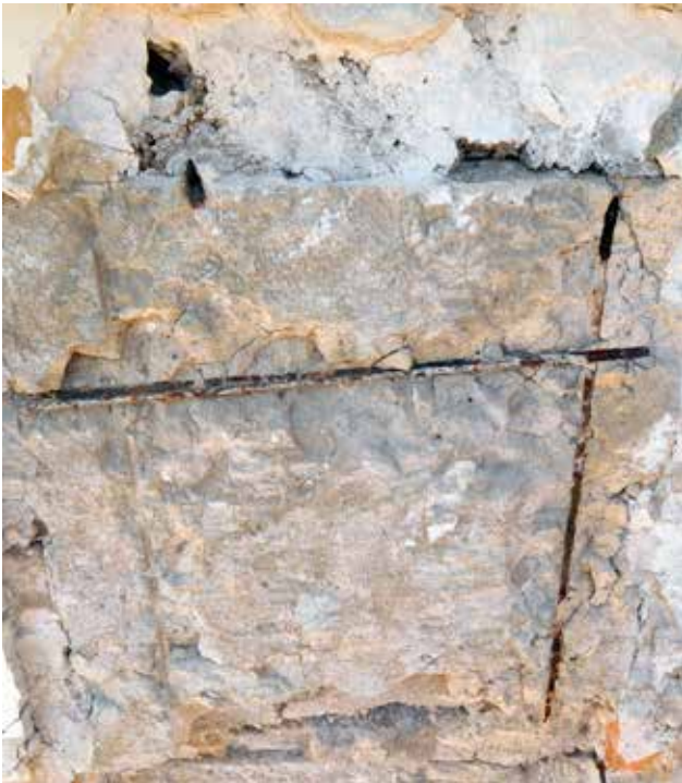
10 Pravokutna betonska kasetna armirana željeznim šipkama – poledina (nosilac) otučenog lijevanog ukrasa na frizu (foto: S. Buble, 2017.) Rectangular concrete cassette reinforced with iron bars – back (support) of removed cast frieze decoration (photo: S. Buble, 2017)
