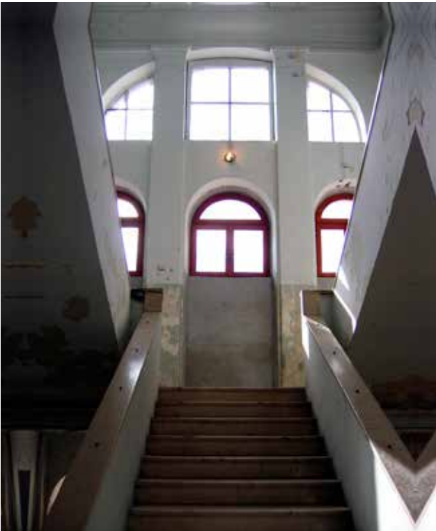
13 Trokrako stubište, podest na prilazu trećem katu. U preuređenju 1947. – 1948. godine profilirani bočni rubovi stuba su otučeni, a izvorna željezna stubišna ograda zamijenjena je punom ogradom od opeke (foto: S. Buble, 2009.).
