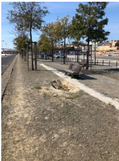
Figura 15: Buraco próximo à área de descanso Fonte: arquivo pessoal Adriana Sixel
