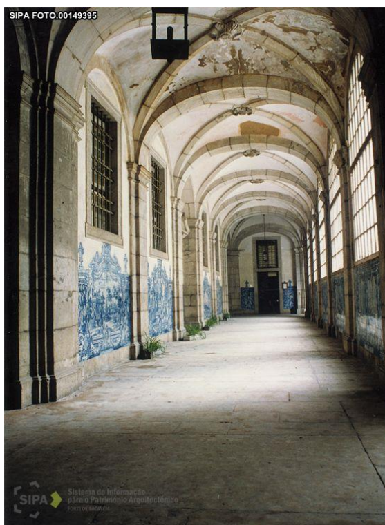
Fotografia 3 – Detalhe dos claustros inferiores antes das intervenções de Jorge Brito e Abreu (DGPC). Note-se as infiltrações no teto e paredes, bem como as arcadas fechadas, revestidas pelos painéis das Fábulas de La Fontaine. SIPAFOTO.00149395, sem data, autor desconhecido, fotografia. Localização: website do SIPA. © 2001-2016 _ Direção-Geral do Património Cultural _ Ministério da Cultura.
