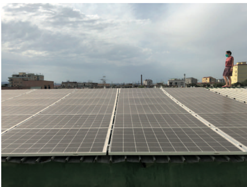
Figg. 5.7 e 5.8 - Fondazione Famiglia di Maria, patio e impianto fotovoltaico installato. Fonte: autori
