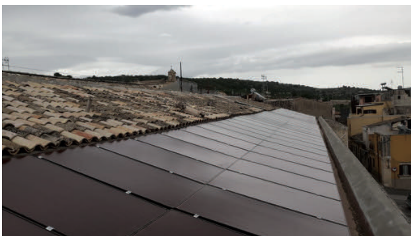
Figg. 5.1 e 5.2 - Impianto fotovoltaico del progetto CommOn Light, Comune di Ferla (SR). Fonte: Comune di Ferla
