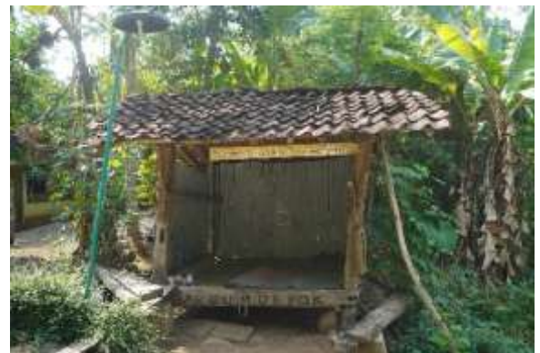
Gambar 3. Bangunan posko penerima wisatawan Kuda Sembrani yang terlihat tidak terawat dengan kurang layak.
